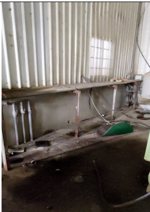
說明：儲存槽之端板破裂情形。
