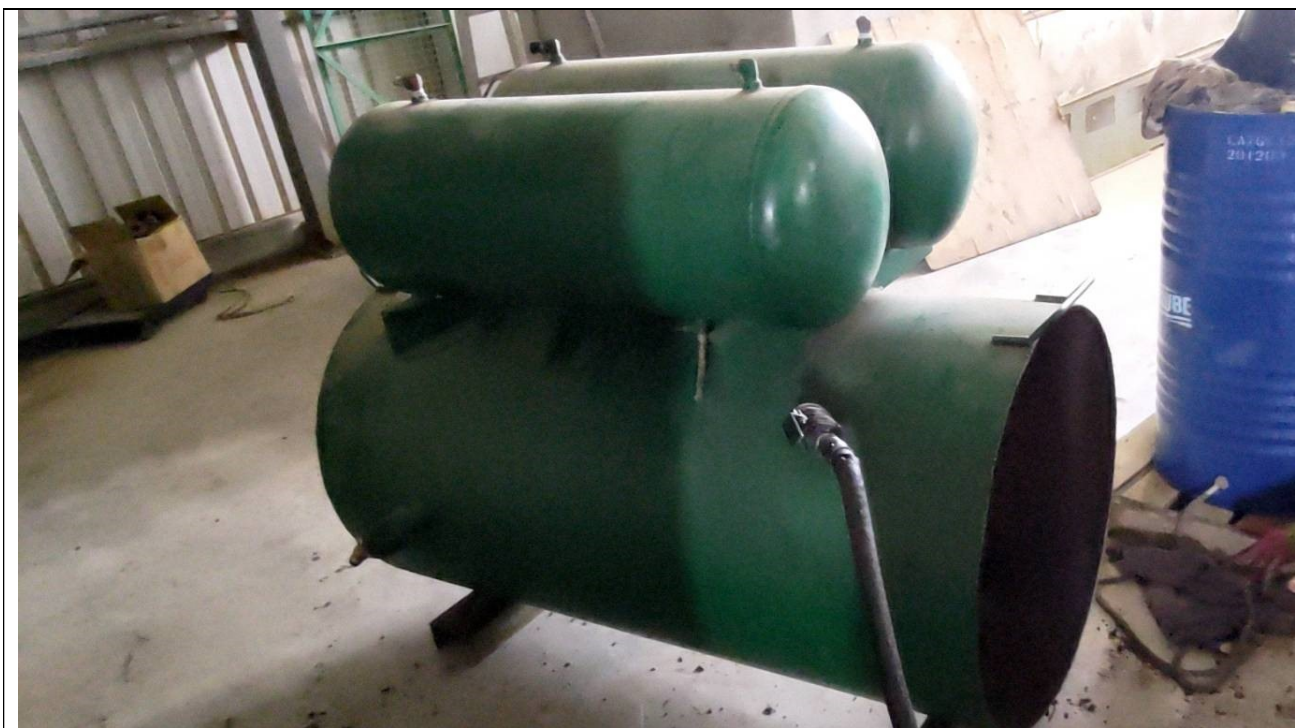
說明：空氣儲存槽過壓破裂情形。
